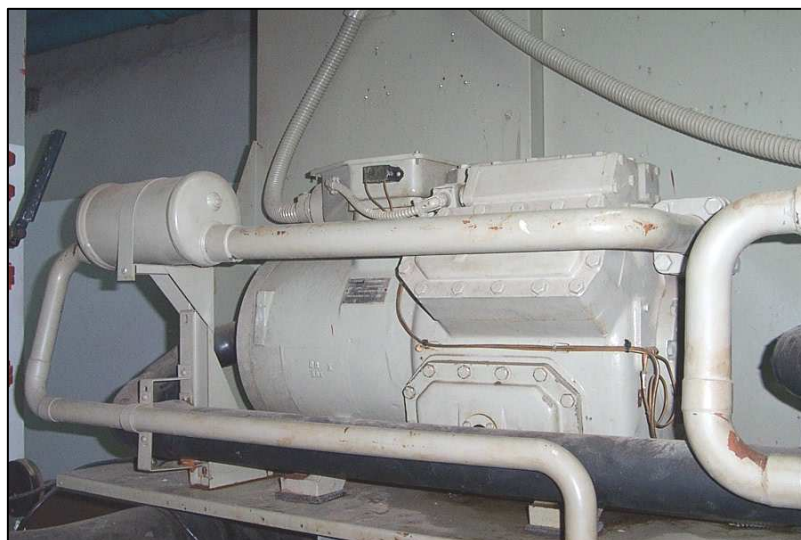
รูปที่ 3 แสดงลักษณะเครื่องอัดสารทำความเย็นแบบลูกสูบ (Reciprocating Compressor)
