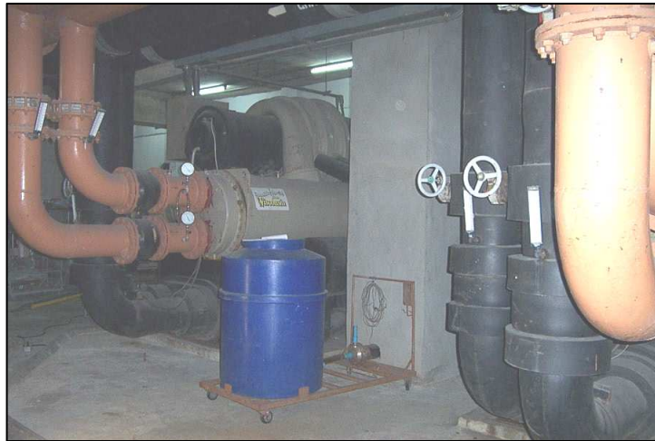
รูปที่ 7 แสดงลักษณะระบบท่อน้ำเย็น (Chilled Water Piping)
