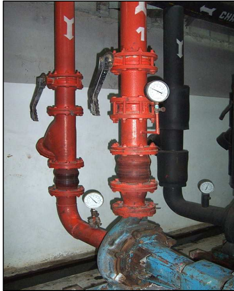
รูปที่ 10 แสดงเครื่องสูบน้ำระบายความร้อน (Condenser Water Pump)
